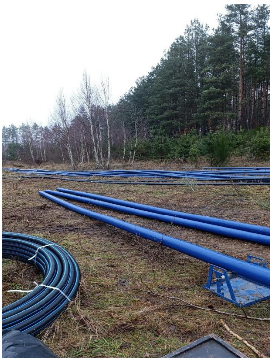
Sieć wodociągowa w Pluskach
